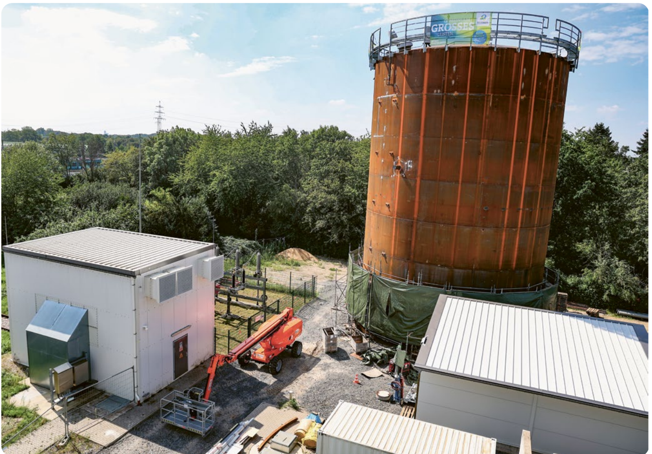
August 2023, die Klimawende nimmt Fahrt auf: Baustelle des neuen Fernwärmespeichers der Rheinenergie Köln
